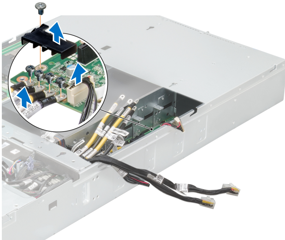
図 95. PDB 2 の電源ケーブルカバーと電源ケーブルの取り外し
