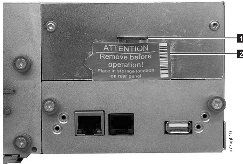
Figure 23. Emplacement de stockage de la clé de verrouillage et de son étiquette sur le panneau arrière de la bandothèque
