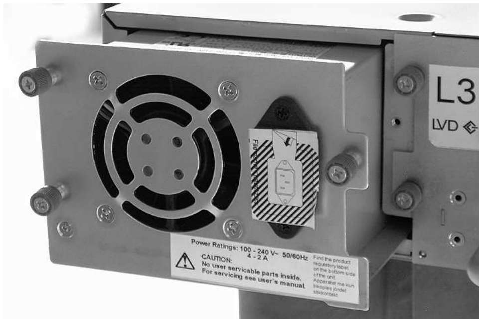
Figura 153. Extracción de una fuente de alimentación de una biblioteca
