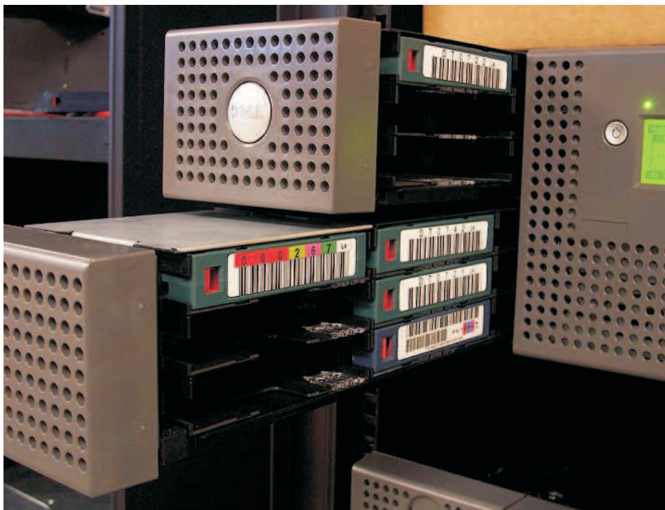
Figura 158. Cargadores izquierdos extraídos de una biblioteca de 4U (frontal de la biblioteca)
