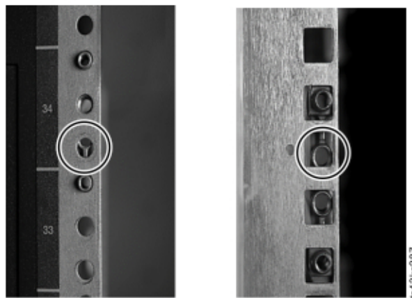
Figure 38. Emplacements de connecteur incorrects
