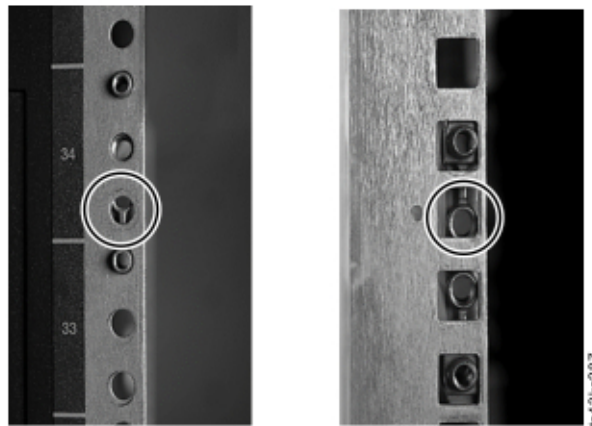
Figure 38. Emplacements de connecteur incorrects
